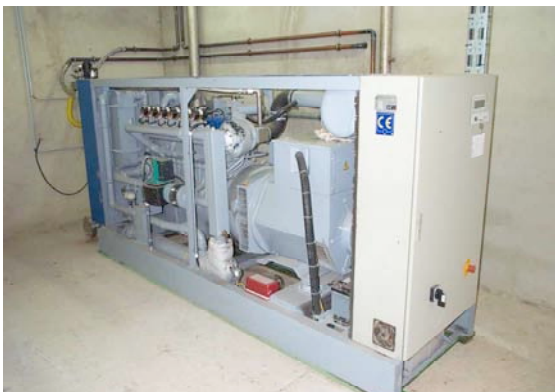
Groupe électrogène Gaz. Photo SOLAGRO
