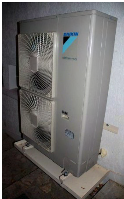
L'évaporateur (source froide) disposé à l'extérieur de la maison
