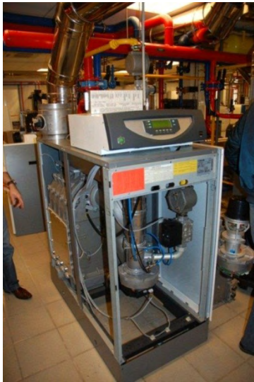
La chaudière C610700 prévue est constituée de deux chaudières assemblée l'une sur l'autre montré sur cette photo
