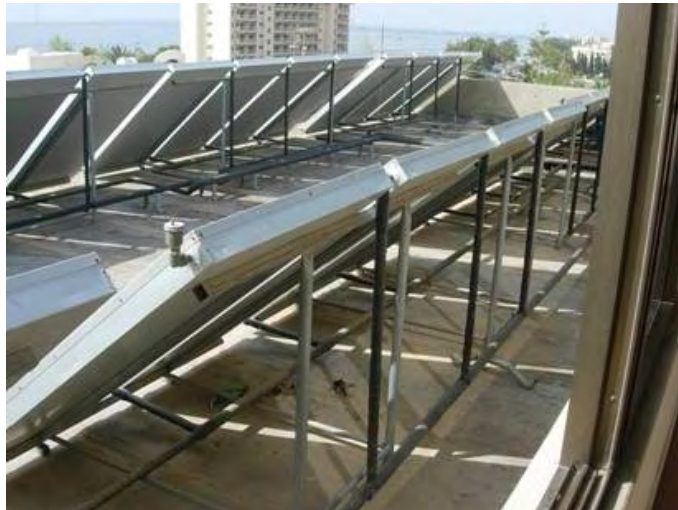
Exemple de cellules thermo solaire en terrasse. On remarque les tuyauteries hydrauliques (purgeur)
