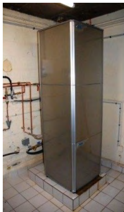
La Partie source chaude de la pompe à chaleur disposé sur le socle de l'ancienne chaudière fioul
