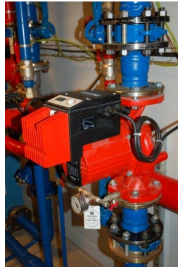
Variateur de vitesse sur l'entraînement des pompes Salmson du circuit d'alimentation en eau chaude
