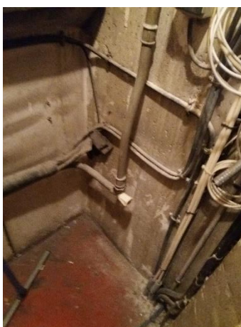
Tés de réglage au niveau des paliers
