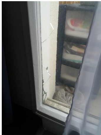
Baie en simple vitrage cassée
