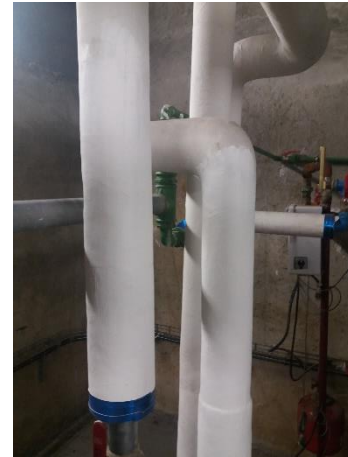
Calorifugeage en chaufferie
