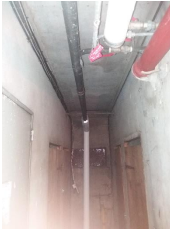
Calorifugeage endommagé en sous-sol
