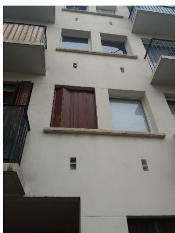
Aérations basses de cuisine, en façade
