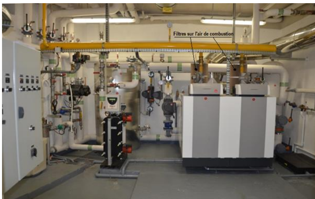
Les deux orifices permettant de connecter le condenseur de la pompe à chaleur aquathermique sont prévus sur le circuit retour des radiateurs (voir à droite de la photo)
